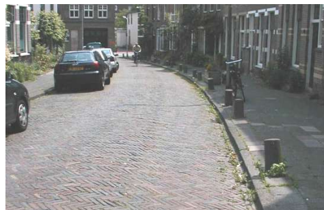
Technisch staat verharding Laag (rijbaan woonstraat)
