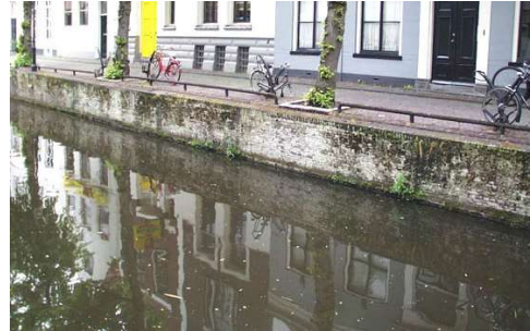
Technische staat kademuur Basis
