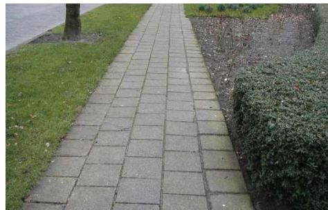
Technisch staat verharding Basis (trottoir)
