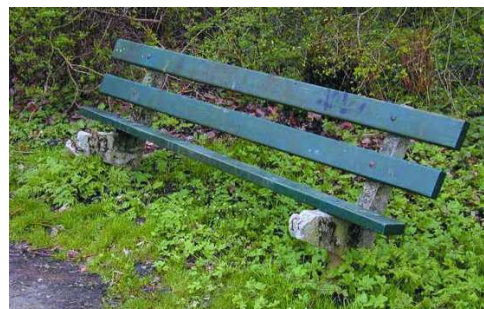
Technische staat meubilair zeer laag.
