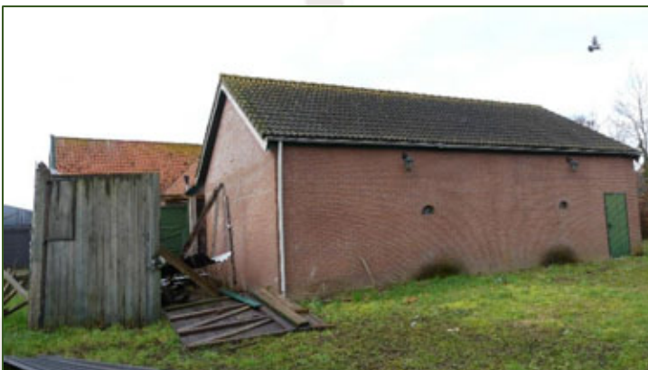
Vervallen overkapping achter opstal A (bron: FF Solutions)
