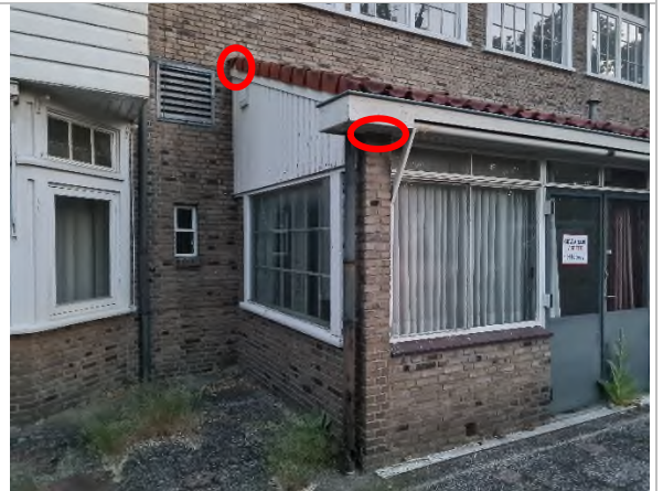
Verblijfplaatsen onder kantpan en achter dakgootbekisting (rood omcirkeld), oostelijk deel Hebron
