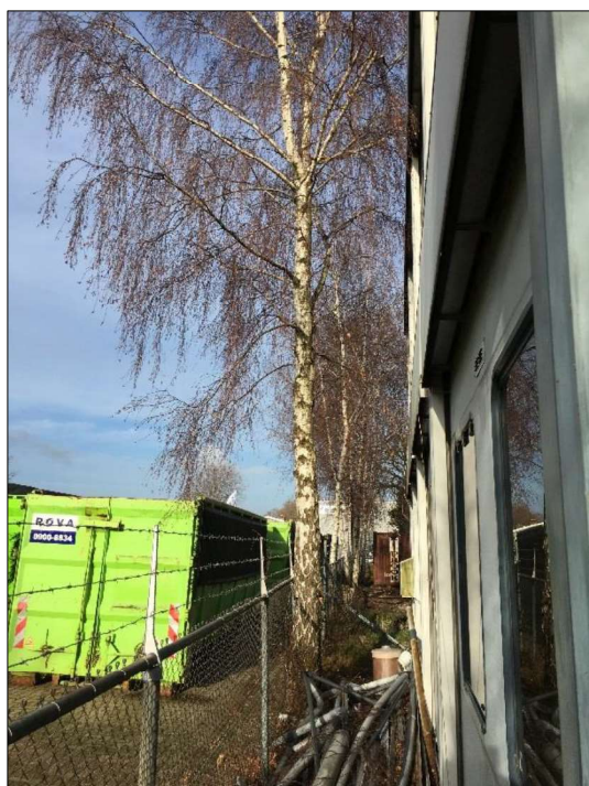
Afbeelding 6: Boom 5. Berk zeer dicht op gebouw;
