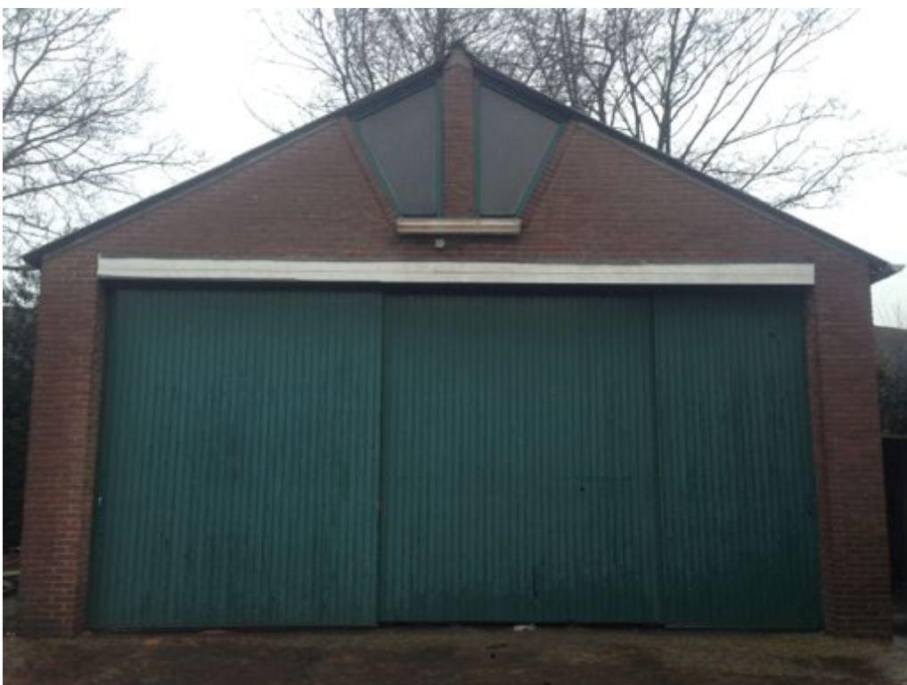
Figuur 2 De schuur is opgetrokken uit steense muren en het dak bestaat uit golfplaten. Tijdens recente storm is ene van de bomen uit de groenstrook op het dak aan de achterzijde terechtgekomen.
